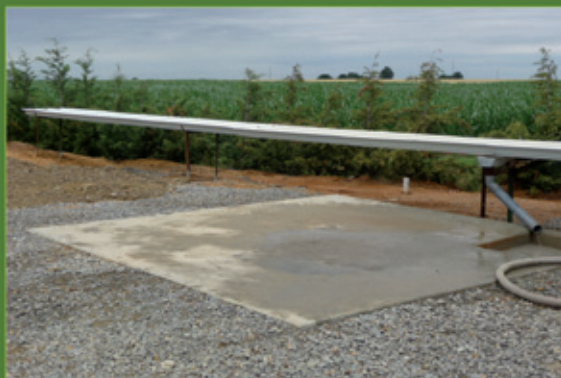
Aire de lavage/remplissage.
